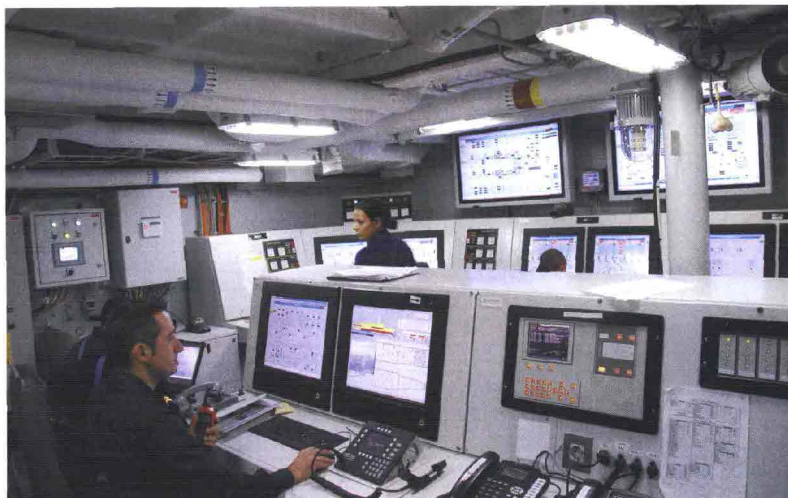
Una vista parziale della Centrale Operativa di Piattaforma che ospita l'SMS (Ship Management System) di Seastema. (foto: EUP)
